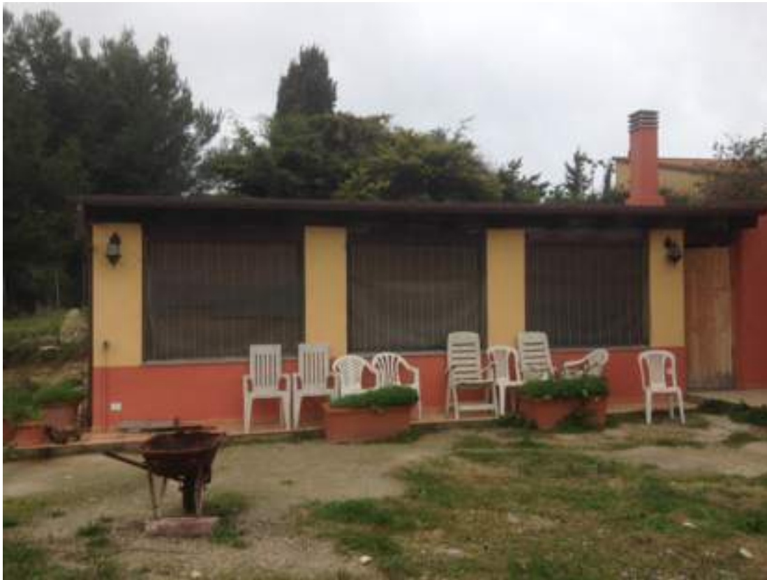
Foto Numero 5 - Superfetazione - Patio Tamponato (Piano S-1)
